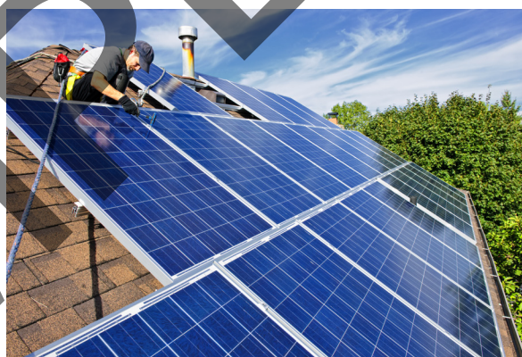
Los paneles solares como estos convierten la energía lumínica del sol en energía eléctrica que la gente puede usar en sus hogares.
